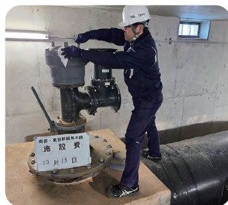
定期的な空気弁の清掃
