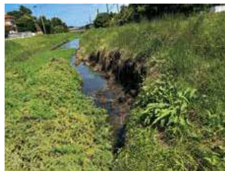
オオフサモによる排水路の崩落 (内谷川排水路:長生村)
